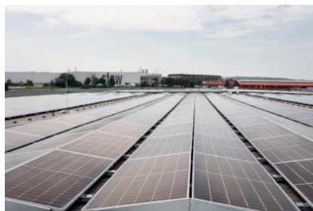
Chladicímu skladu společnosti Billa v Modleticích od loňského roku dodává energii jedna z největších střešních fotovoltaických elektráren v Česku. Střechu chladicího skladu pokrývá 1 847 panelů, celkový výkon elektrárny je 1MWp a roční výroba energie 1,1 GWh.
